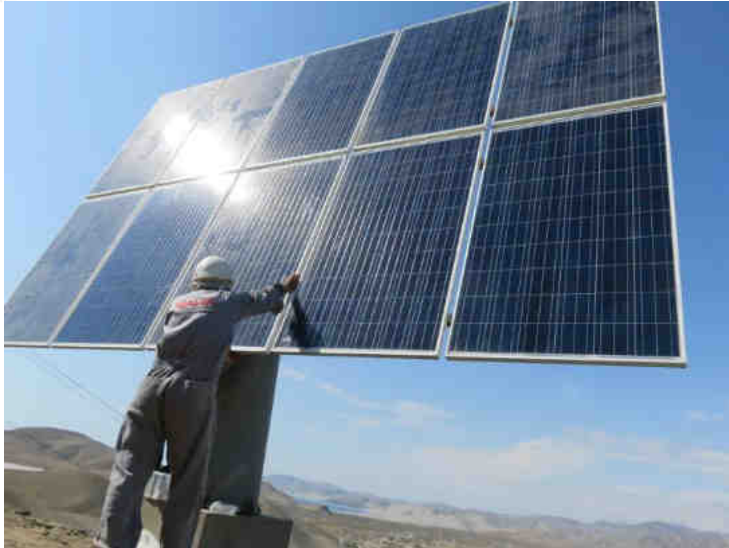
10 kW de módulos fotovoltaicos en 4 pedestales regulables Norte-Sur
