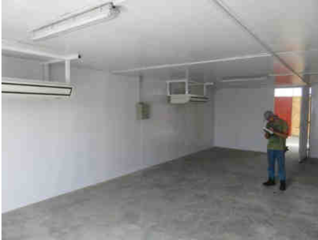
CONSUMO: Cámara refrigerada con 2 grupos de A/C de 5.5 kW
